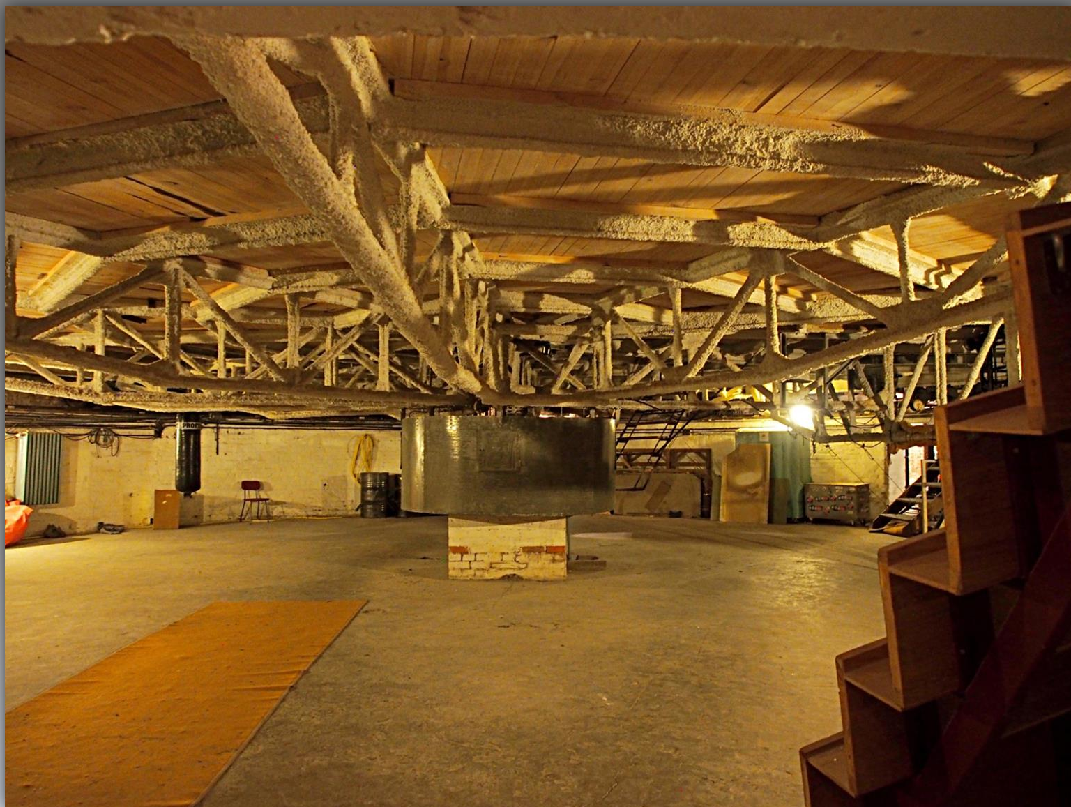
Pomieszczenie techniczne sceny
