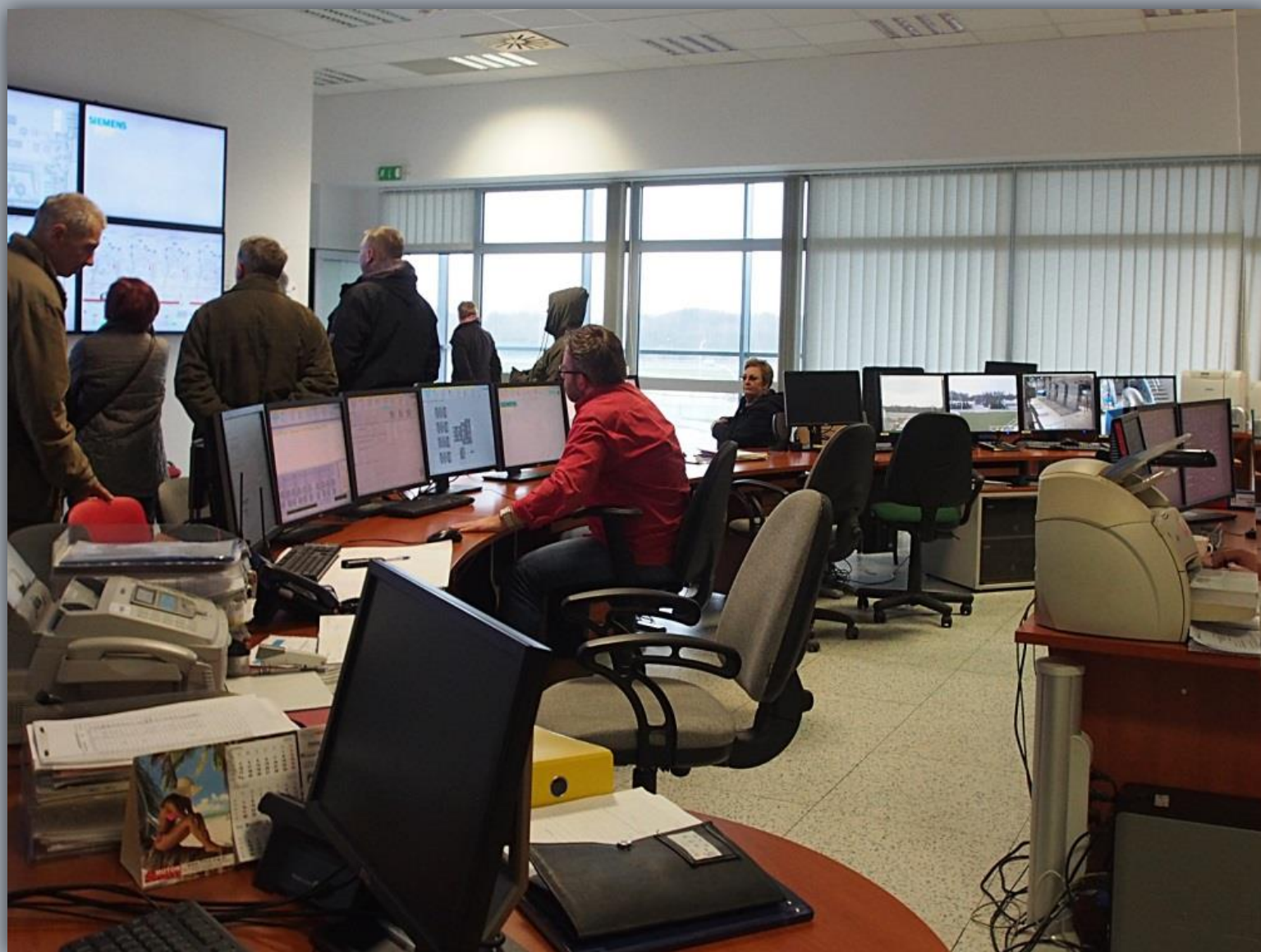
Centrum dowodzenia pracą oczyszczalni ścieków
