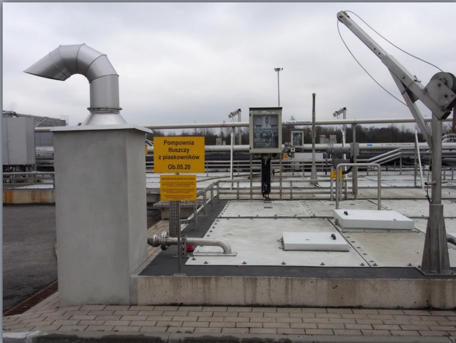
Pompownia tłuszczy z piaskowników
