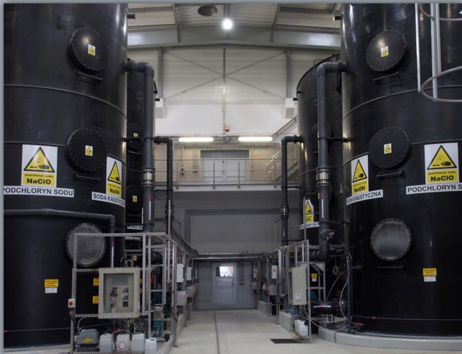
Wewnątrz budynku biologicznego oczyszczania ścieków
