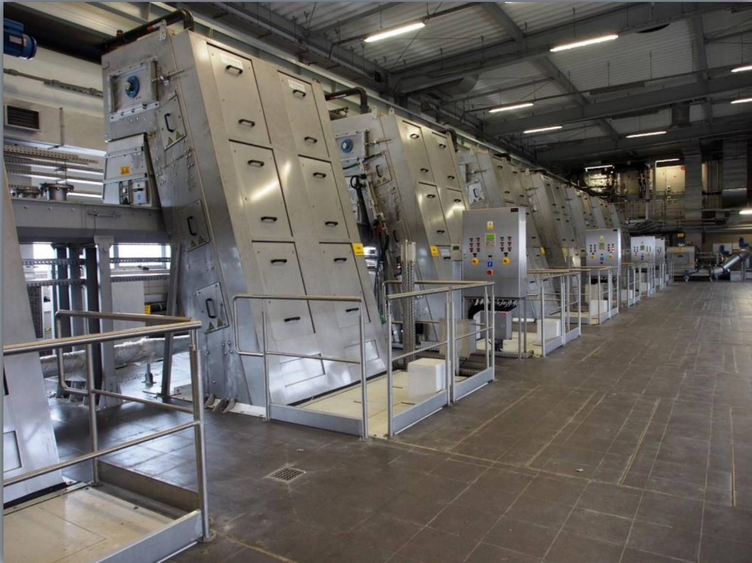
Budynek krat, w których zatrzymywane są zanieczyszczenia stałe
