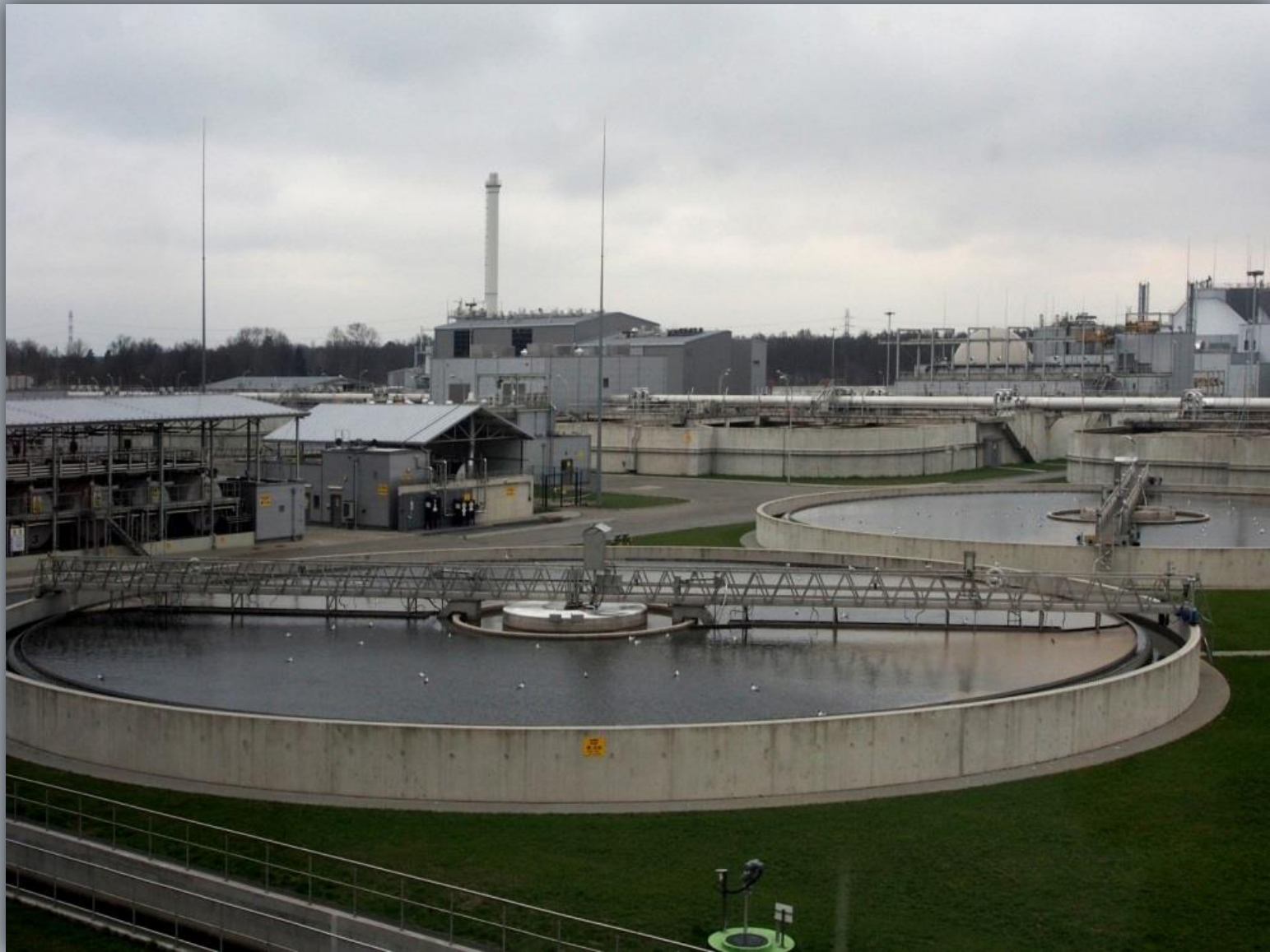
Osadniki wtórne i reaktory biologiczne
