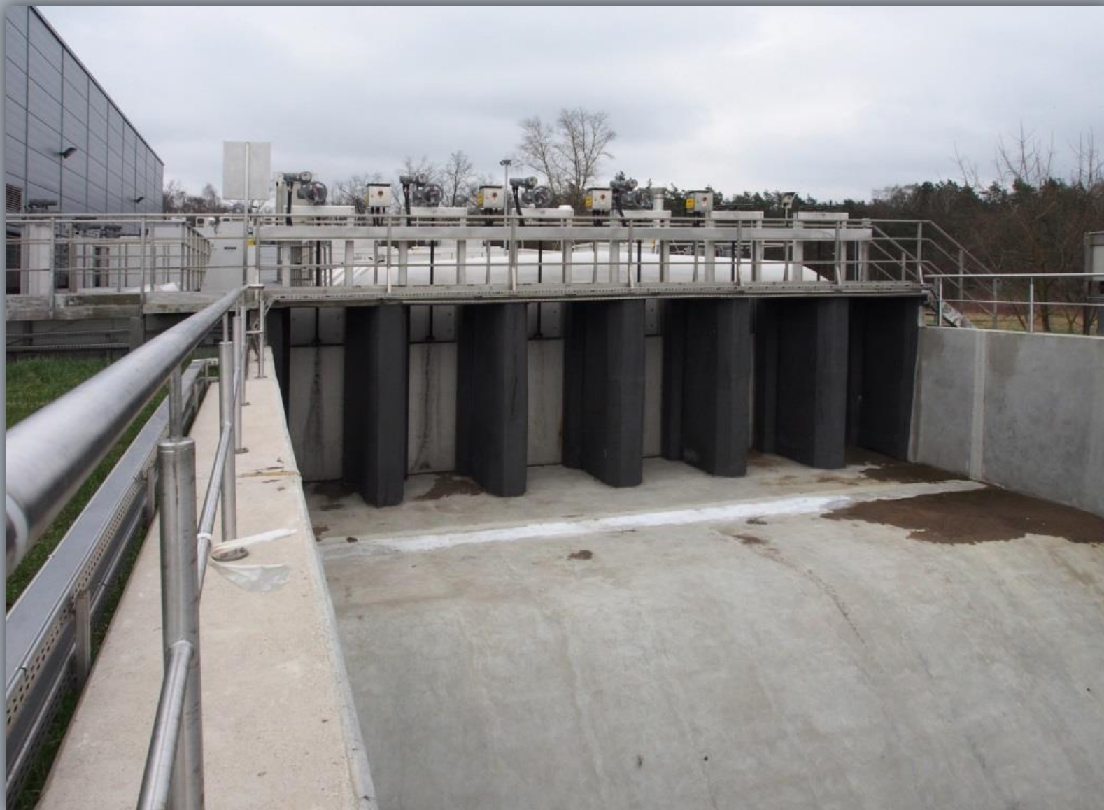
Komora zasuw; ścieki dopływają do zbiorczej komory dopływowej
