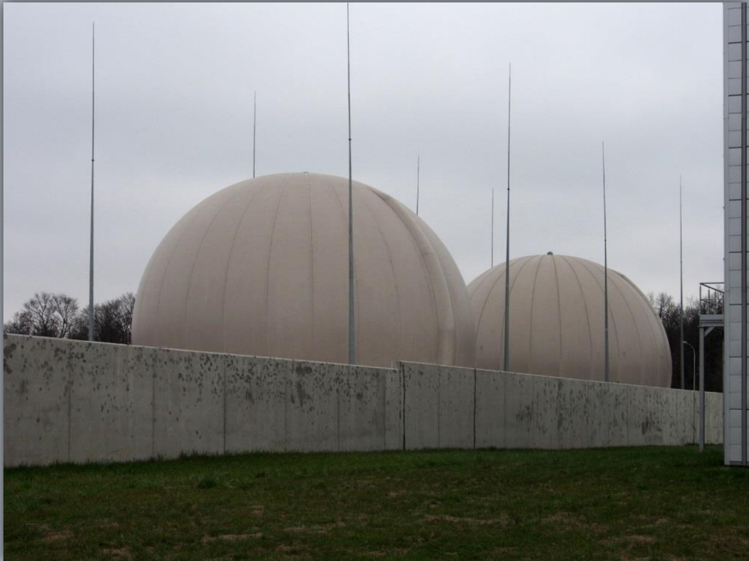
Zbiorniki z biogazem powstającym w procesie technologicznym
