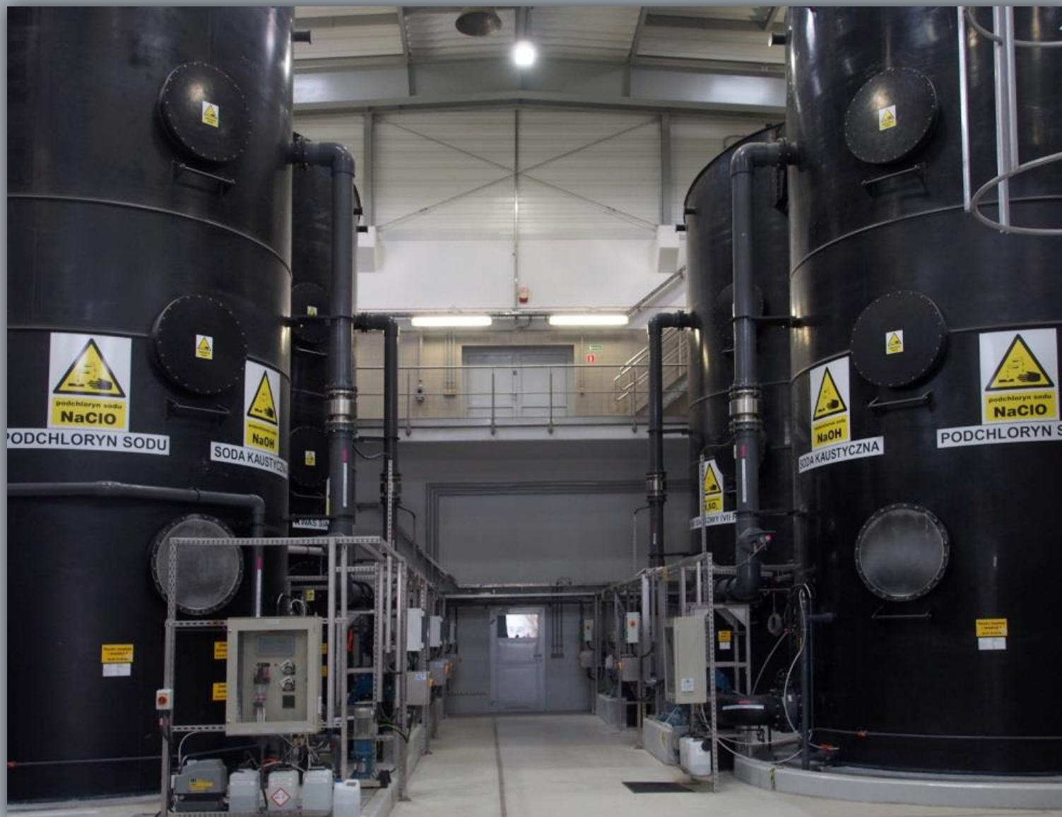
Wewnątrz budynku biologicznego oczyszczania ścieków
