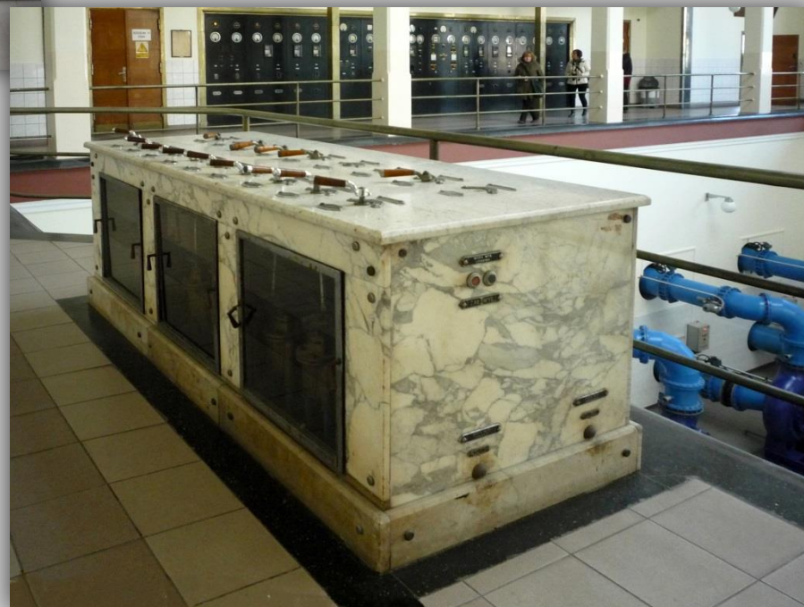
Pompy w Zakładzie Filtrów Pospiesznych oraz konsola techniczna
